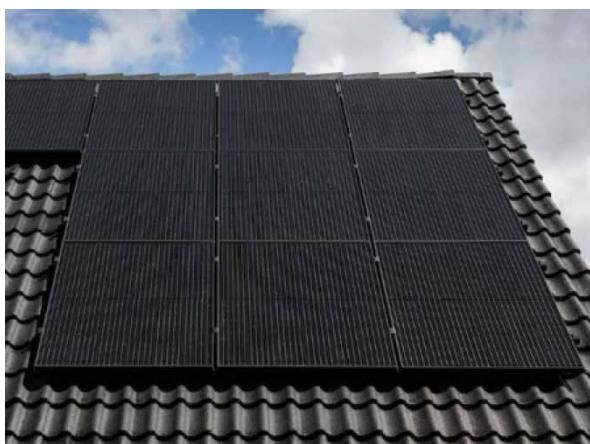
Voorbeeld: PV panelen op-daks-systeem, aantal panelen volgens Beng berekening;
